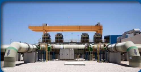
Jubail 3A IWP, KSA
